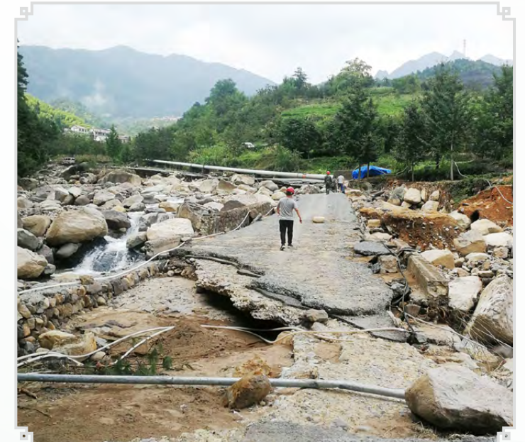
浙江省衢州市常山县地灾隐患排查现场
