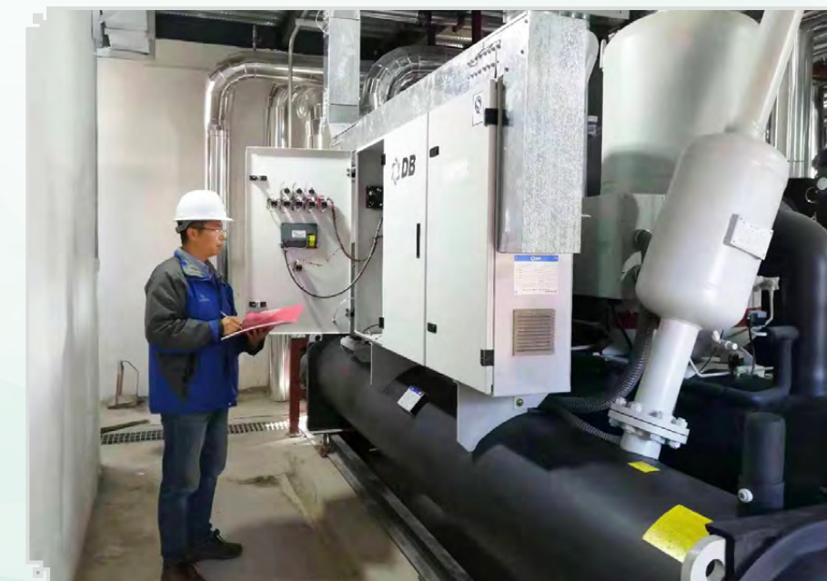
咸阳文彩舫小区项目中整洁的地热能源站机房
